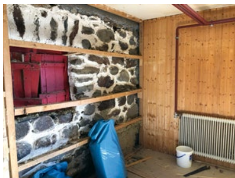
Überraschung: alte Mauer und Fenster hinter der Vertäfelung
